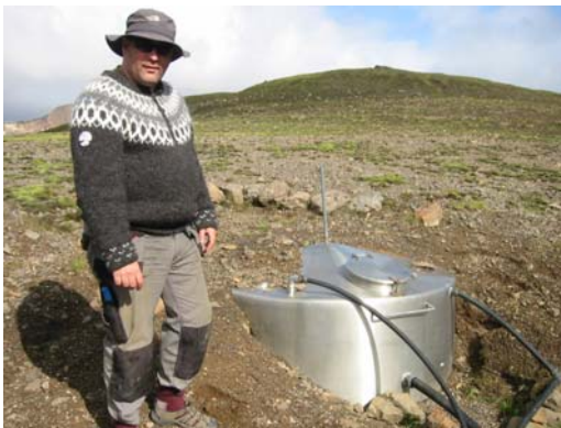
Mynd 3.6 – Miðlunartankur f. kalt vatn, lokað kerfi
